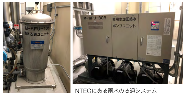
NTECにある雨水のろ過システム
